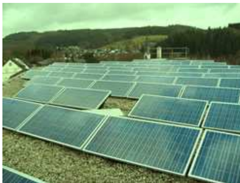
Photovoltaikanlagen auf dem Neubau der Gemeinschaftshauptschule in Hellenthal
